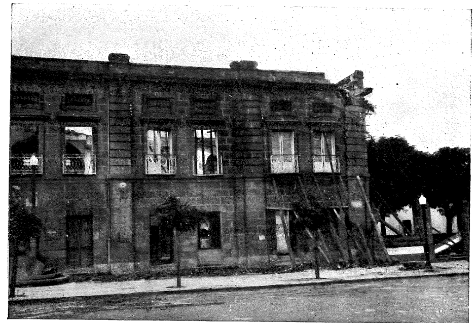
Grietas en un edificio por hundimiento de las areniscas modernas de su base.
